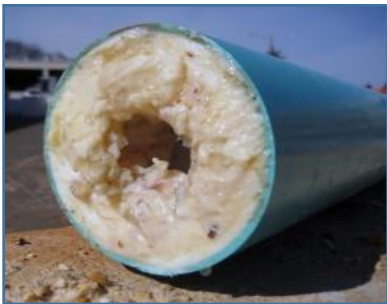
Actual pipe with FOG buildup
